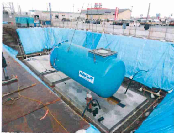
耐震性貯水槽
